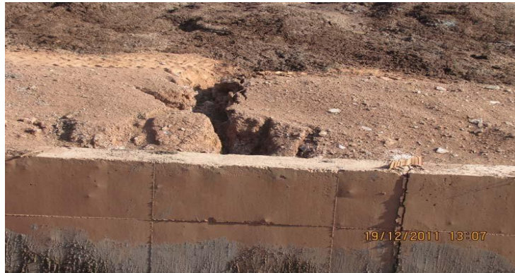
شکل ۲. خرابی موجود در مجاورت کانال انتقال آب سیمین‌دشت به گرمسار
