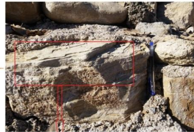
تخریب فیزیکی ناشی از هوازگی نمک
