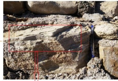
تخریب فیزیکی ناشی از هوازدگی نمک
