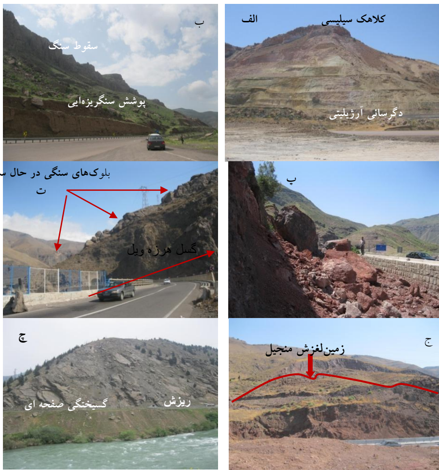
شکل ۴. نمایی از زمین لغزش‌های رخ داده در مسیر آزادراه قزوین - رشت، الف) سقوط بلوک‌های سنگی در قسمت بالای ترانشه و زمین لغزش در سری سنگ‌های آندزیت با آلتراسیون شدید (ایستگاه اول: کیلومتر ۷۰۰+۴۲). ب) سقوط و ریزش بلوک‌های سنگی در سری سنگ‌های آندزیتی و پوشش سنگریزه‌ایی در قسمت پایین ترانشه (ایستگاه ۹: کیلومتر ۶۰۰+۵۲، عکس به-سمت جنوب شرق گرفته شده است. پ) ریزش بلوک‌های سنگی در سری سنگ‌های آندزیتی و نهشته‌های آذرآواری (ایستگاه ۱۰: کیلومتر ۹۰۰+۵۷). ت) سقوط و ریزش بلوک‌های سنگی در سری سنگ‌های آگلومرای خاکستری (ایستگاه ۱۵: کیلومتر ۱۴۰). ج) زمین لغزش منجیل که در تاریخ ۹۲/۴/۹۲ اتفاق افتاد و از کیلومتر ۸۰۰-۱۰۲+۵۰۰ آزادراه را مسدود کرد. عکس روبه جنوب گرفته شده است. چ) گسیختگی صفحه‌ای به موازات شیب توپوگرافی و ریزش در سری کنگلومراهای هوازده سازند شمشک در ناحیه خلیل آباد رودبار (ایستگاه ۲۱: کیلومتر ۱۰۵).
