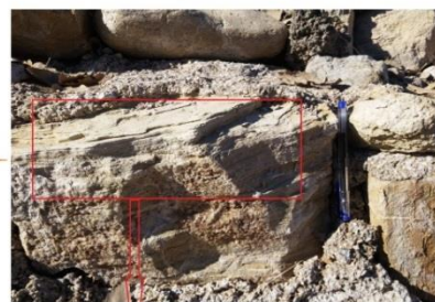
تخریب فیزیکی ناشی از هوازدگی نمک
