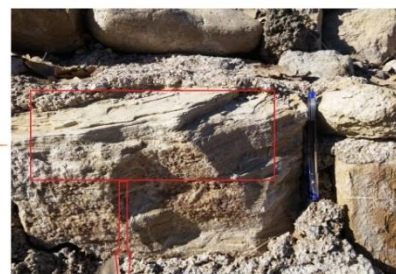
تخریب فیزیکی ناشی از هوازدگی نمک
