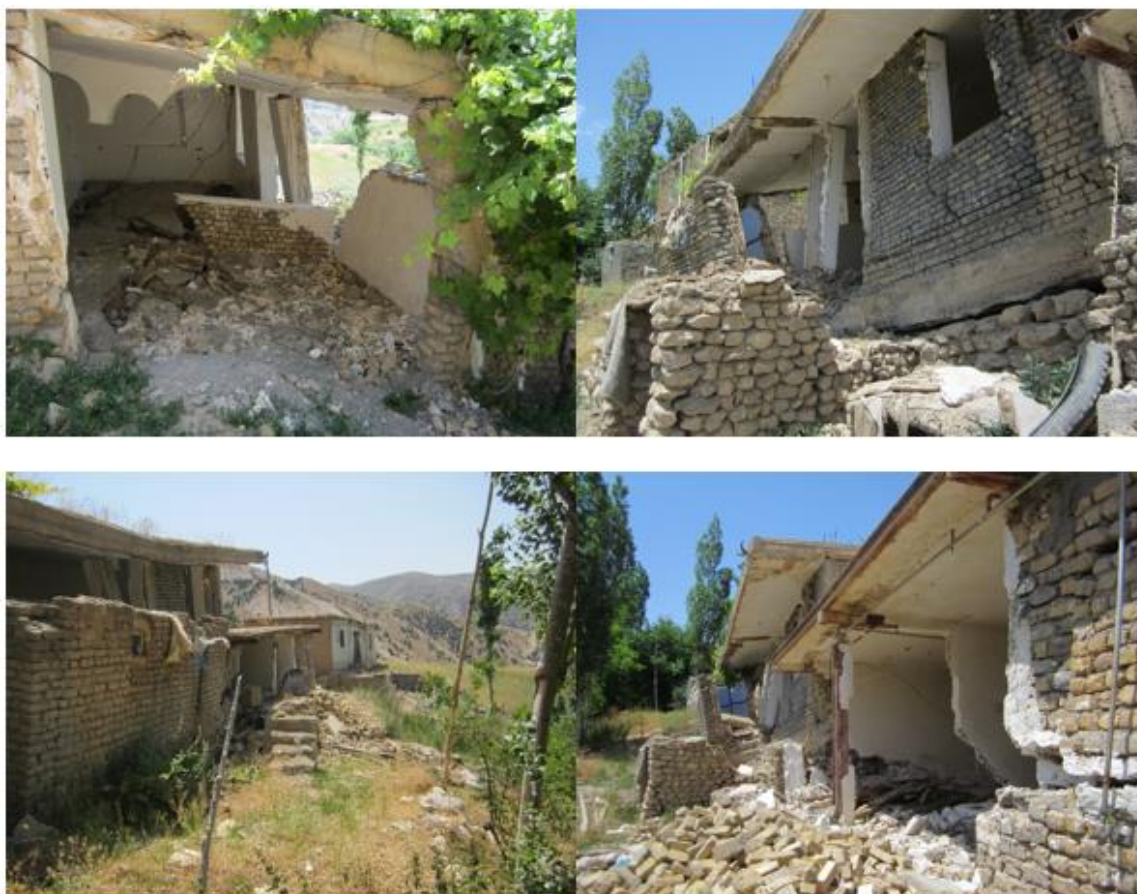
شکل ۱. ترک‌های ایجاد شده و تخریب منازل مسکونی روستای تولوبین ناشی از رخداد زمین‌لغزش
