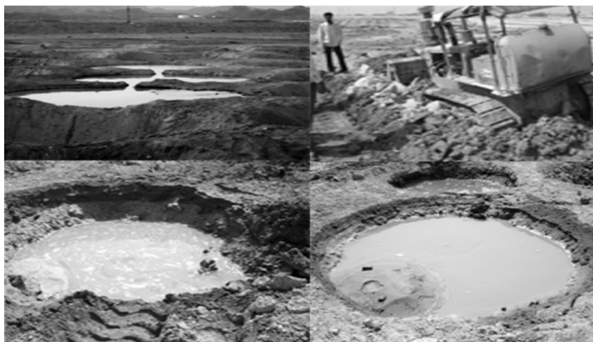
شکل ۱۳. تصاویری از مشکلات مشاهده شده در پروژه در حین انجام عملیات تراکم دینامیکی
