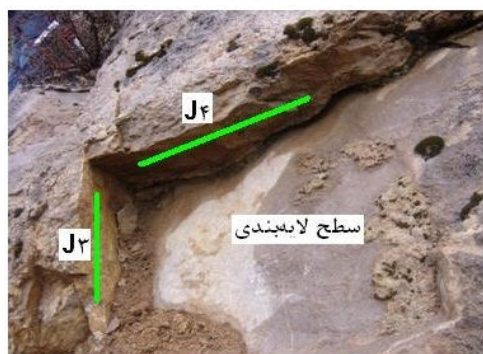
شکل ۸. سیستم درزه‌های J 3 ، J 4 و لایه‌بندی
