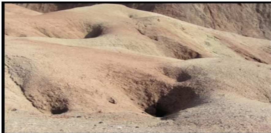
شکل (۷) پدیده پای پینگ در سطح گنبد‌های نمکی
