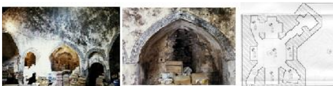
شکل (۵). پلان، بینه و گرمخانه حمام بی بی (منبع: آرشیو میراث فرهنگی کرمانشاه، ۱۳۹۹)
