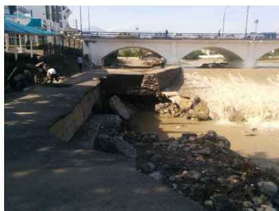
شکل (۲) تخریب خیابان زیرگذر پل چشمه کیله واقع در مرکز شهر تنکابن (مهر ۱۳۹۷)
