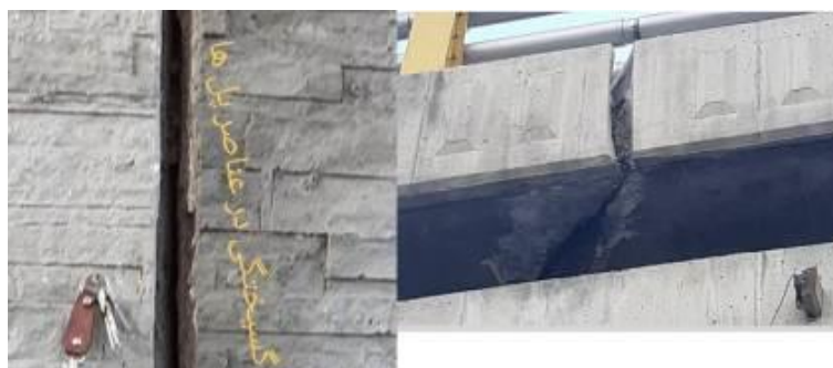
شکل - ۲۷: نمونه‌هایی از گسیختگی در عناصر پل‌های موجود در منطقه ۱۸ شهری تهران
