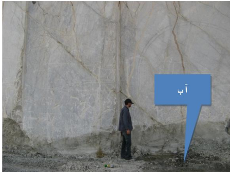
شکل ۱۶. نمایی از درز J15 چنان‌که در تصویر مشخص است در اثر تراوش آب در راستای صفحه درز، تجمع آب در پای پله صورت گرفته است (دید به سمت شمال خاور)
