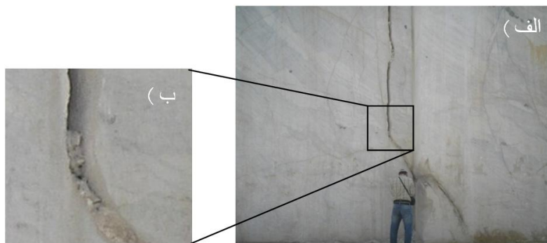
شکل ۶. الف) تصویر درز J7 که با درز پایینی خود ساختار قلاب‌شدگی را نشان می‌دهد. این ساختار داخل محدوده مستطیلی و با پیکان قرمز رنگ مشخص شده است (دید به سمت جنوب باختر) ب) نمای نزدیک از ساختار قلاب‌شدگی
